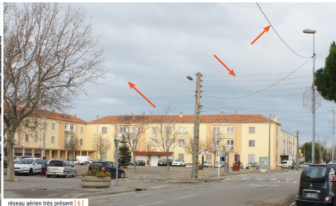
réseau aérien très présent [ 6 ]
